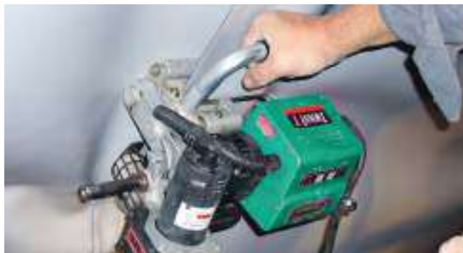
TWINNY T с практичной поперечной рукояткой во время сварки над головой в туннеле
