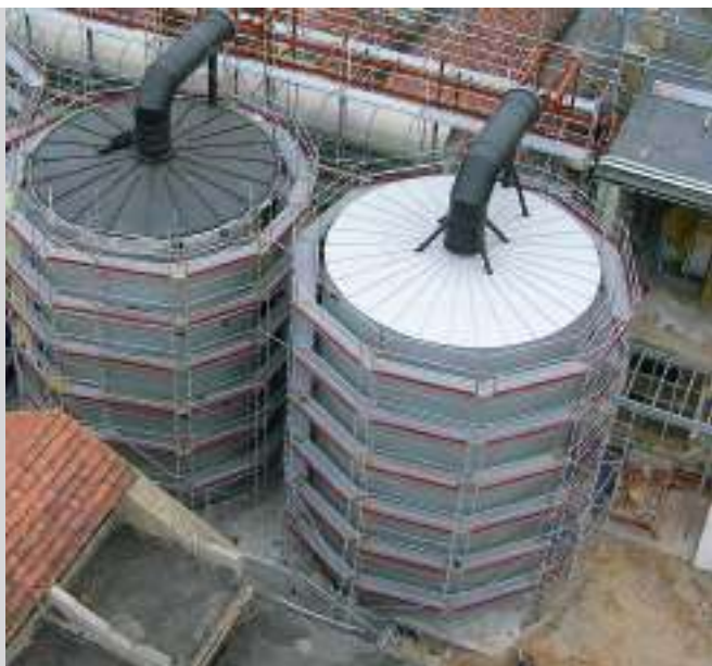
Система очистки воздуха, Испания. Материал: HD-PE
